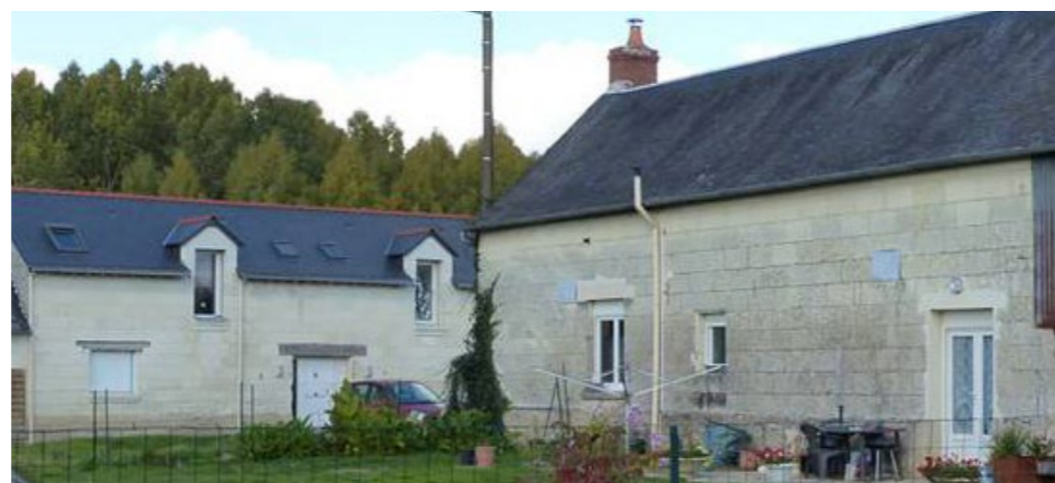
Figure 195 : Ferme en tuffeau avec fenêtres PVC, volets roulants, ouvertures créées aux proportions inadaptées, hors du périmètre de la ZPPAUP. (AB - architecte)
