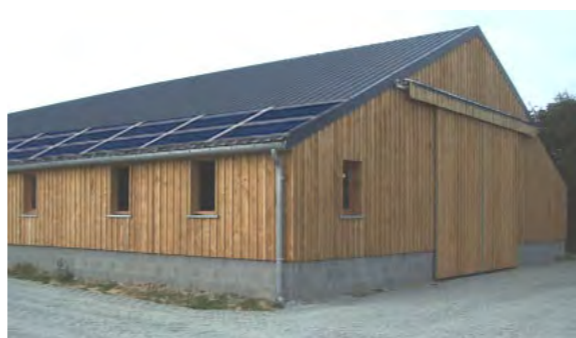
Image 2 : implantation de capteurs en partie basse de la couverture
